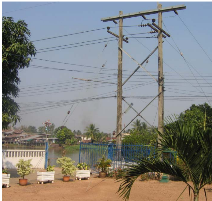
รูปที่ 3-19 แสดงระบบจำหน่ายแรงสูงบน เสา H-Frame ยึดโยงล้าเข้าพื้นที่ผู้ใช้ไฟ
