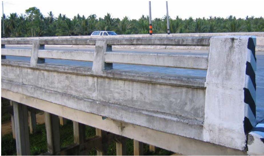
รูปที่ 2-24 แสดงด้านนอกราวสะพานแบบที่มีทางเดินเท้าติดอยู่กับผิวการจราจรของกรมทางหลวงแบบที่ 3
