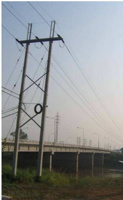
รูปที่ 3-17 แสดงโครงสร้างเสา H-Frame ข้ามแม่น้ำ
