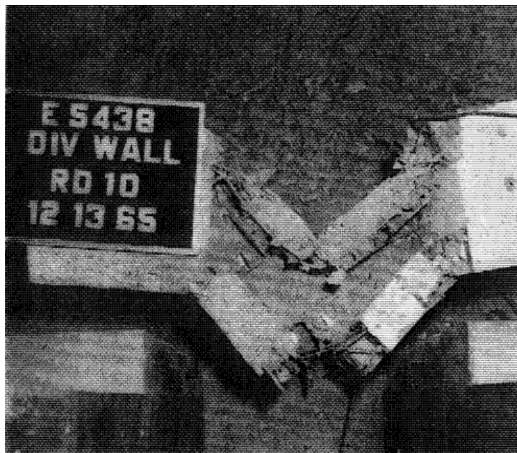
รูปที่ 6-5 ลักษณะของสะเก็ดแตกหักของชิ้นส่วนโครงสร้างคอนกรีตเสริมเหล็กที่มีการเสริมเหล็กปลอกแบบถัก (ที่มา: Unified Facilities Criteria: Structures to Resist the Effects of Accidental Explosions (UFC 3-340-02))
