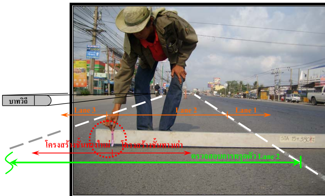
รูปที่ 4 : ลาดหลังทาง (Crown Slope) ระหว่างช่องจราจร (Lane) ไม่รับกัน เนื่องจากการทรุดตัวของโครงสร้างทางเก่ากับใหม่ไม่เท่ากัน
