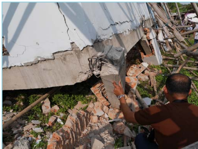
เสาตอม่อเอียงออกนอกแนว อาคารทรุดตัวลง
