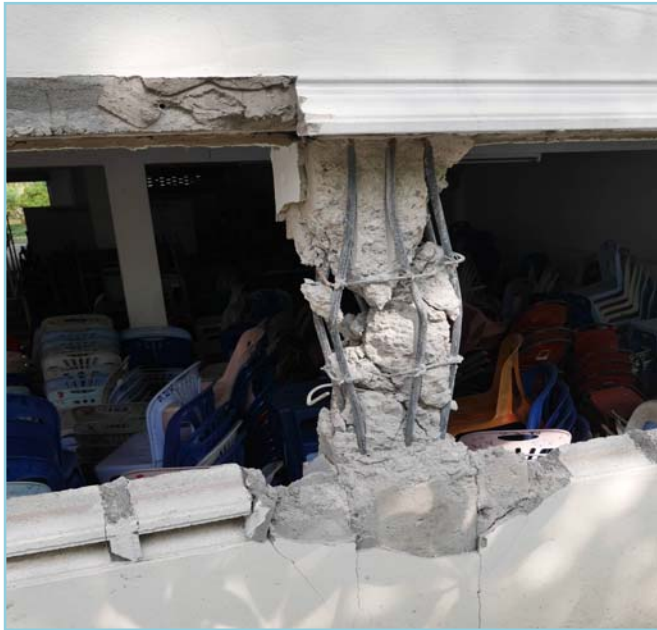
คอนกรีตเสาระเบิดขาดจากกัน
