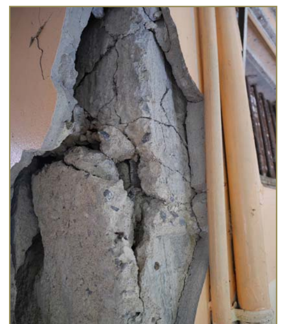
เสาอาคารโก่งแตกมองเห็นเหล็ก
