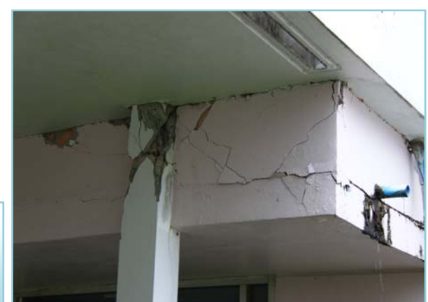
คอสอดแตกเฉียง และมีผนังหรือคาน บริเวณเดียวกันแตกร้าว
