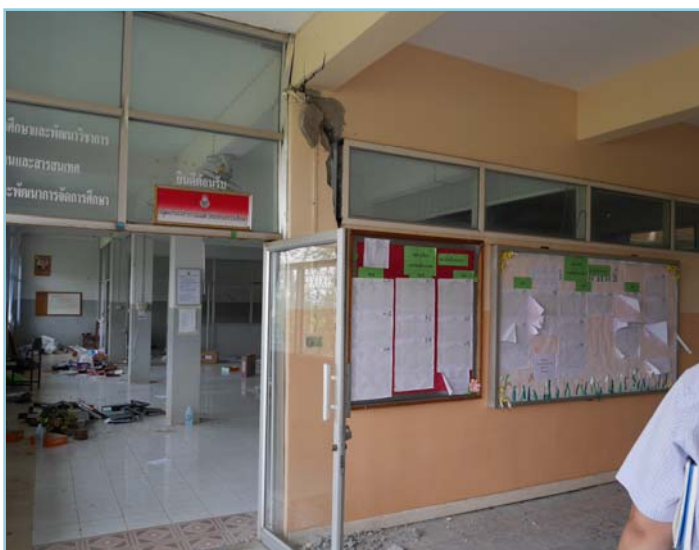
เสาแตกเฉียง ส่วนใหญ่พบบริเวณคอสอด้านบน บริเวณตำแหน่งจุดต่อกับคาน
