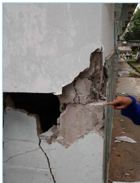
ตำแหน่งรอยต่อเหล็กเสริมหรือคอนกรีต แตกแยกออกจากกัน
