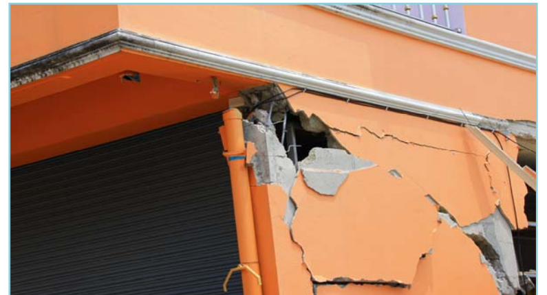
ผนังและเสาอาคารแตกขาดจาก
