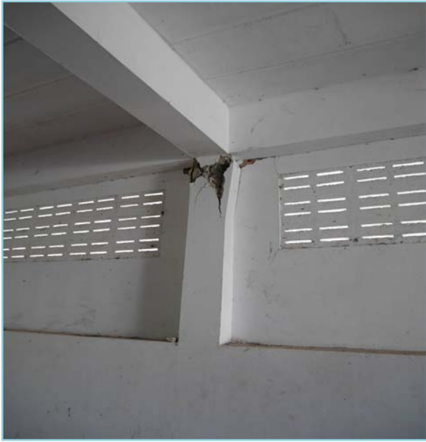
คอสเสาแตกเป็นกาะบาด ส่วนใหญ่จะพบบริเวณปลายเสาที่ต่อกับคาน
