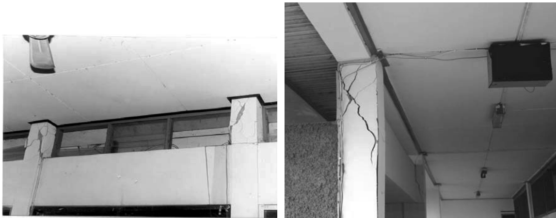
รูปที่ 3.2-1 ตัวอย่างการวิบัติเนื่องที่เกิดขึ้นในเสา
