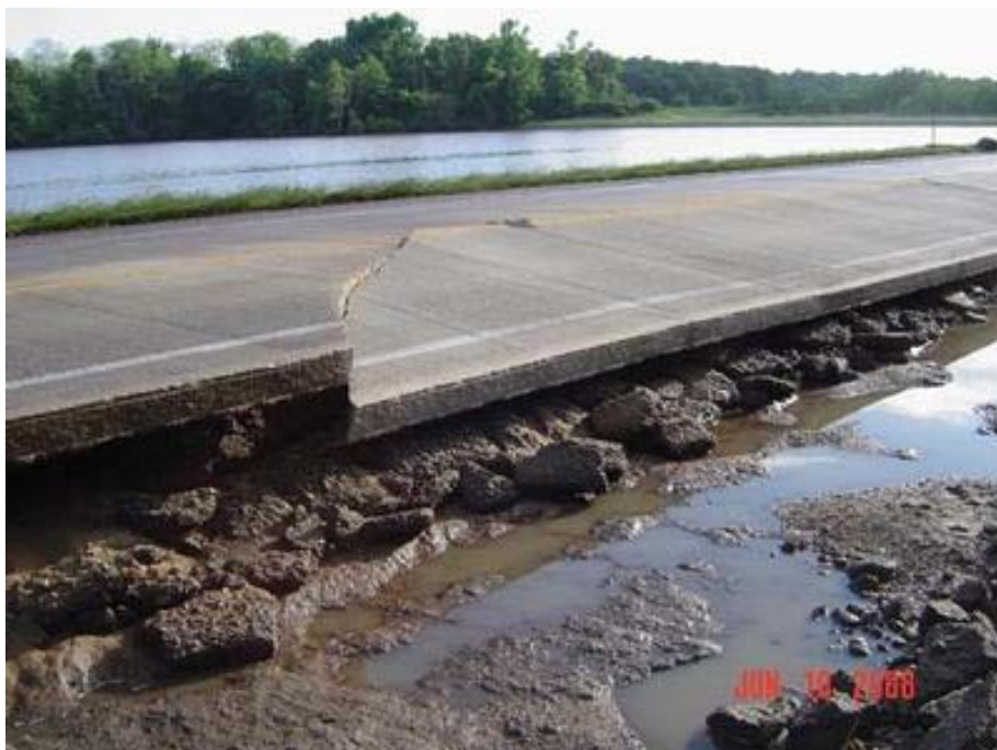
รูปที่ ๒๐ การกัดเซาะด้านท้ายน้ำของถนนผิวทางคอนกรีต
