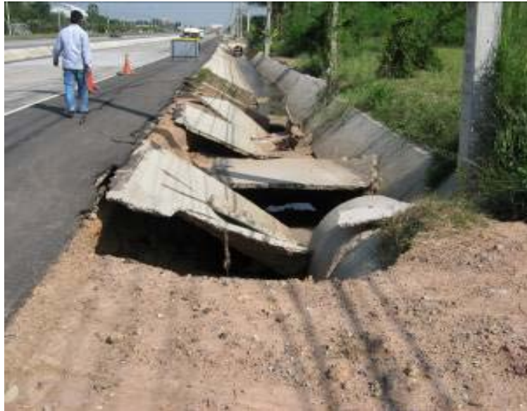
รูปที่ ๒๑ Concrete Slope Protection เคลื่อนตัว เนื่องจากถูกกัดเซาะ
