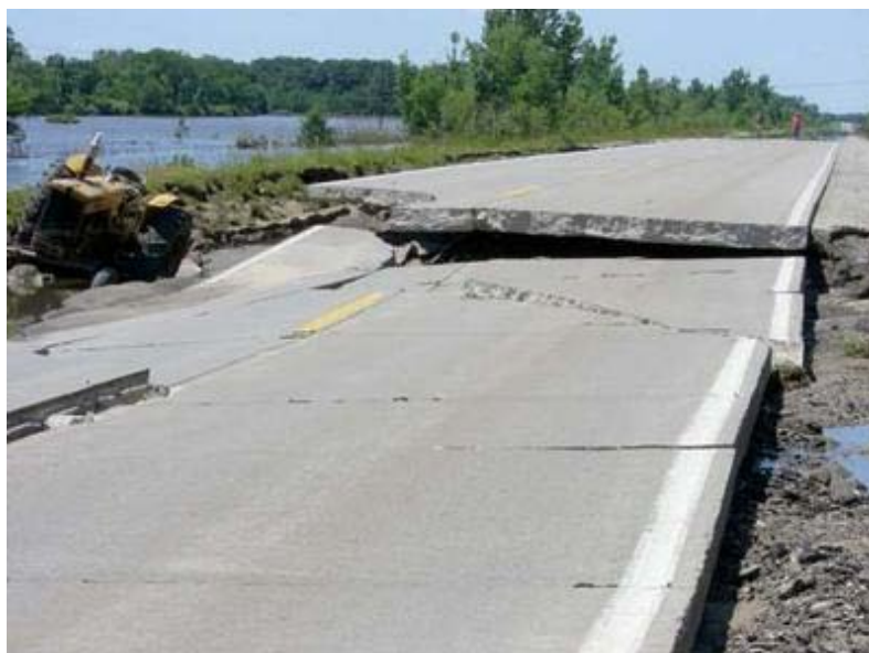
รูปที่ ๒๔ ถนนผิวทางคอนกรีตขาด
