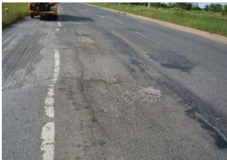
รูปที่ ๘ เครื่องหมายบนผิวทางหลุดลอก
