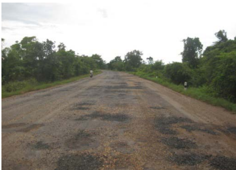
รูปที่ ๙ ผิวทางหลุดล่อนจากความชื้นภายหลังประสบอุทกภัย
