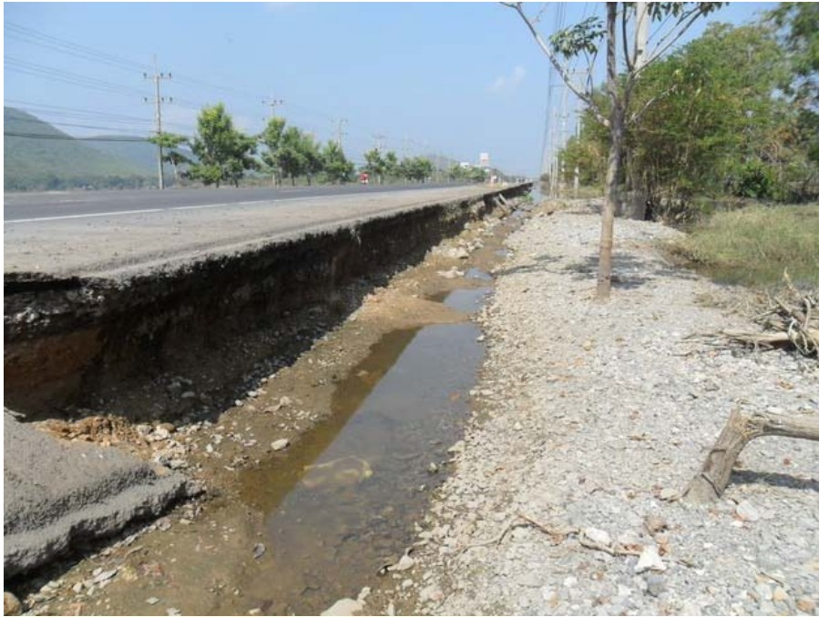
รูปที่ ๑๙ การกัดเซาะด้านท้ายน้ำของถนนผิวทางแอสฟัลต์คอนกรีต
