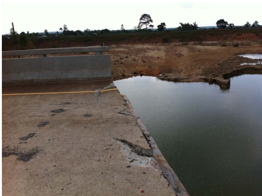
รูปที่ ๒๖ คอสะพานขาด
