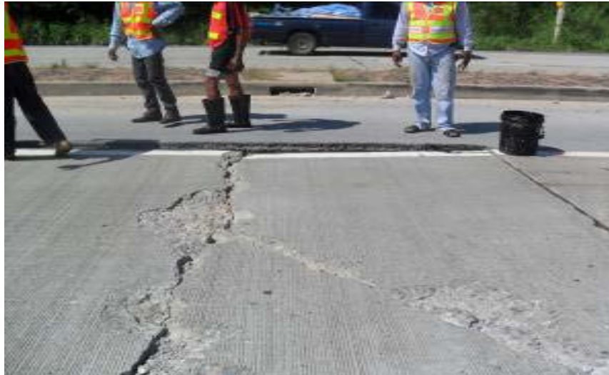
รูปที่ ๑๖ แผ่นพื้นคอนกรีตแตกเป็นเสี่ยงหลังประสบอุทกภัย
