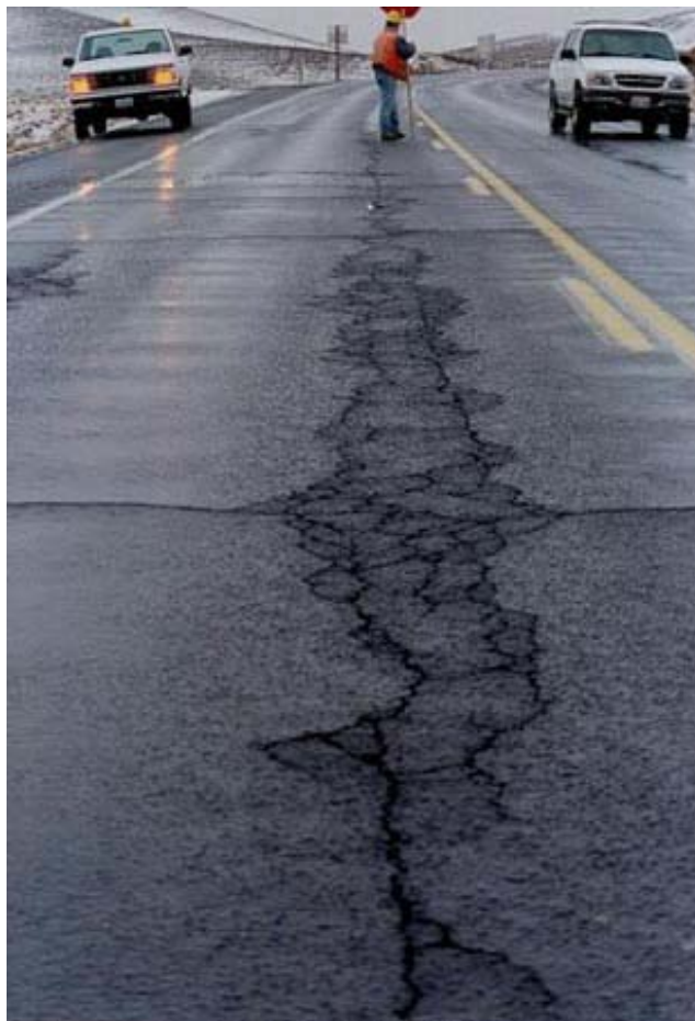
รูปที่ ๑๐ ผิวทางเกิดรอยแตกเนื่องจากแอสฟัลต์คอนกรีตเกิดการหลุดลอกภายหลังประสบอุทกภัย
