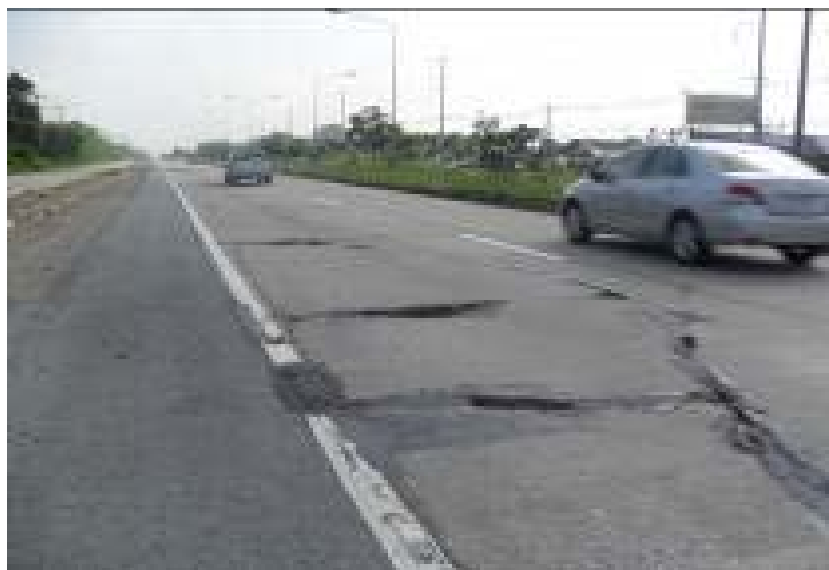
รูปที่ ๑๗ ผิวกอนกรีตทรุดตัวต่างระดับภายหลังกน้ำท่วม
