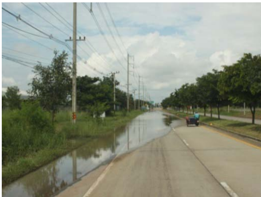
รูปที่ ๑๕ การเกิดยุบตัวภายหลังประสบอุทกภัย
