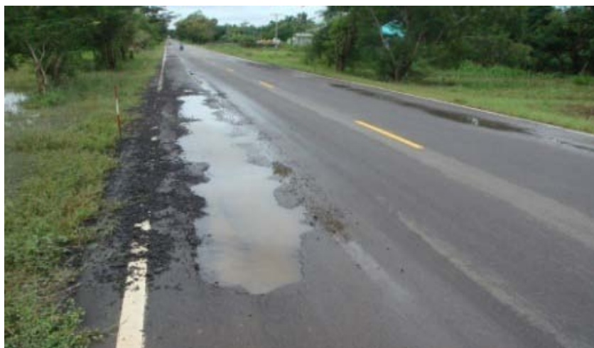
รูปที่ ๑๔ การเกิดร่องล้อภายหลังประสบอุทกภัย
