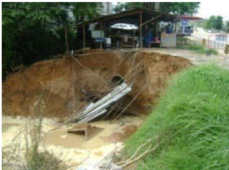
รูปที่ ๒๒ การกัดเซาะบริเวณปากท่อลอด
