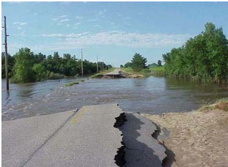
รูปที่ ๒๓ ถนนผิวทางแอสฟัลต์คอนกรีตขาด
