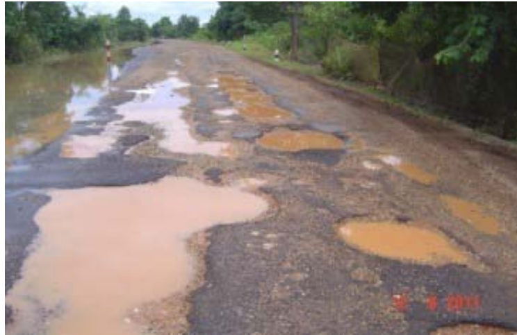
รูปที่ ๑๓ หลุมบ่อที่เกิดขึ้นหลังระดับน้ำลดลง
