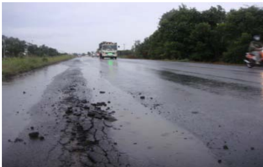
รูปที่ ๑๑ ผิวทางแตกร้าวจากการหลุดลอกภายหลังประสบอุทกภัย
