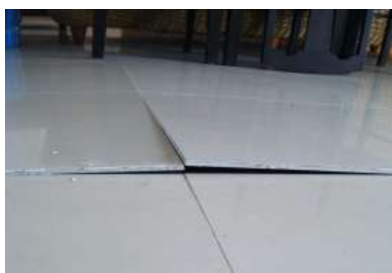
รูปที่ 7.3 การปูกระเบื้องที่วัสดุยึดใต้ท้องกระเบื้องไม่เต็มแผ่น เช่น ตามมุมกระเบื้อง เมื่อน้ำหนักมากลงมุมใดมุมหนึ่ง ทำให้กระเบื้องหลุดและมุมด้านตรงข้ามลอยขึ้น
