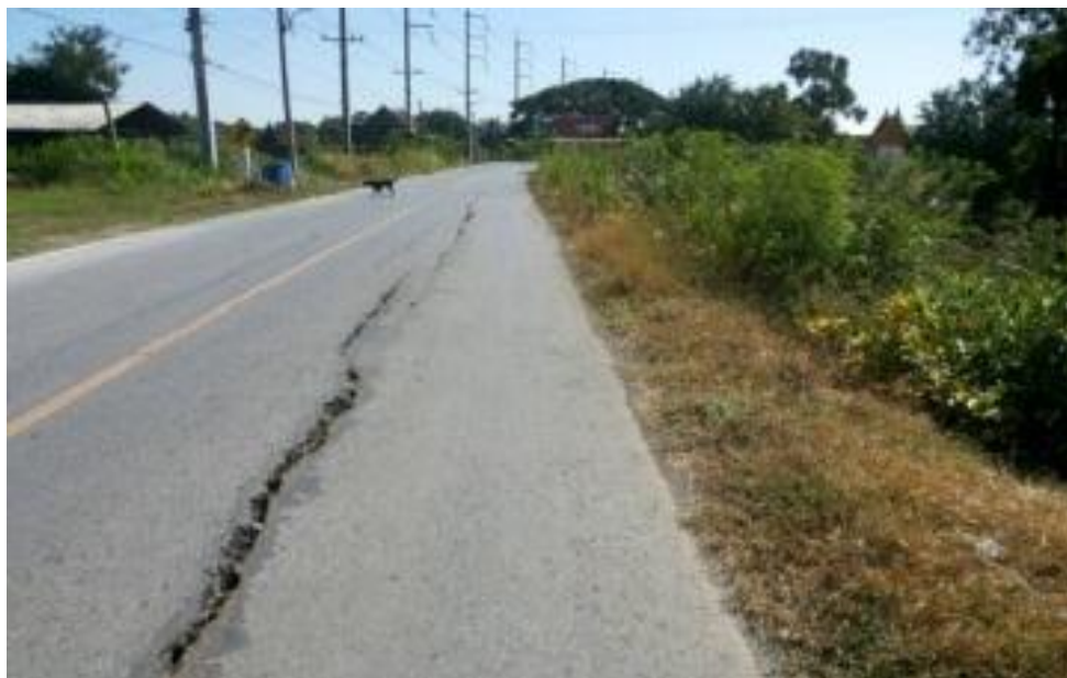
รูปที่ 8 รอยแตกที่เกิดขึ้นบนผิวทาง
