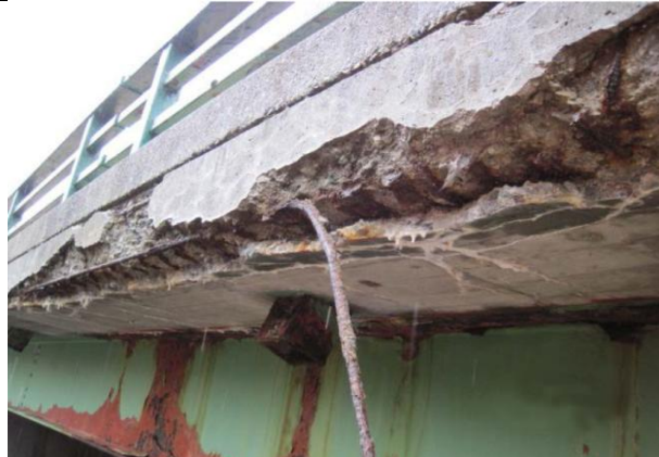
คอนกรีตหุ้มหลุดล่อน และเหล็กเสริมหลุดออก
