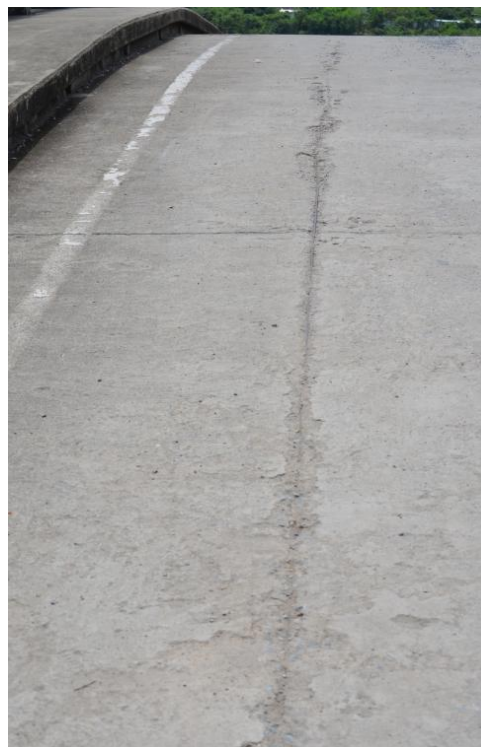
ผิวทางหลุดล่อนจนเห็นเหล็กเสริม
