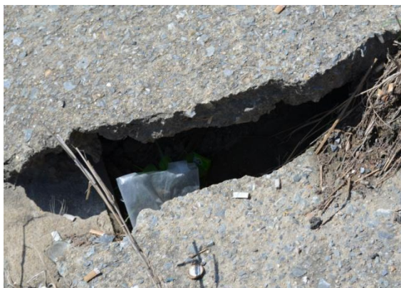
คอสะพานมีการทรุดตัว แยกออกจากสะพาน
