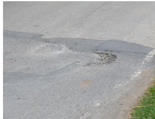
คอสะพานมีความต่างระดับมากและเป็นหลุม
