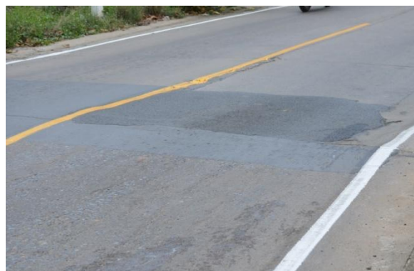
มีความต่างระดับของคอสะพานกับสะพานเล็กน้อย
