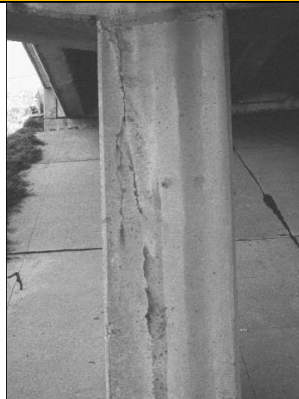
เสาตอม่อมีรอยแตกขนาดมากกว่า 0.2 มม.
