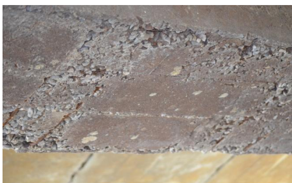
คอนกรีตเป็นโพรง เนื่องจากจี้ไม่ดี และเหล็กเสริมเกิดสนิม
