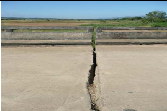
รอยต่อแตกออก มีขนาดใหญ่กว่า 10 ซม.
