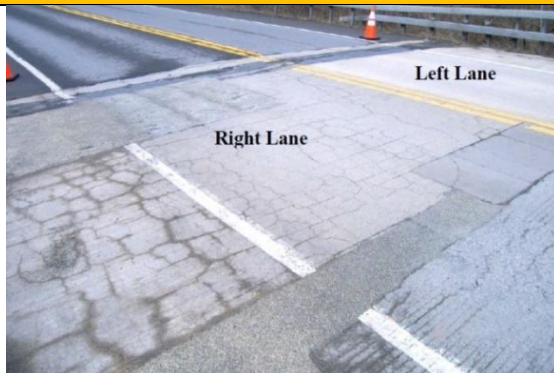
คอสะพานมีรอยแตกในสองทิศทาง
