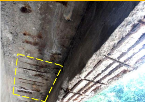
คอนกรีตหุ้มหลุดล่อนและเหล็กเสริมขึ้นสนิม
