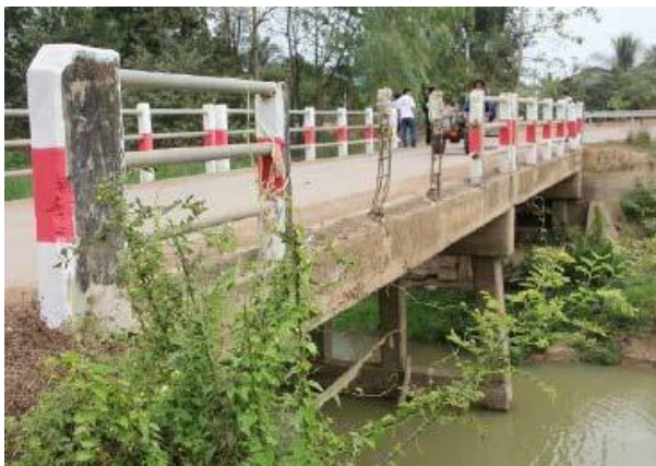
ราวสะพานเสียหายพังทลาย ผู้ใช้สะพานอาจตกลงไปได้
