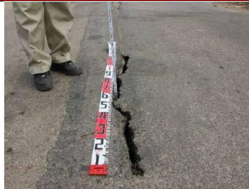
คอสะพานมีการทรุดตัว แยกออกจากตัวสะพาน
