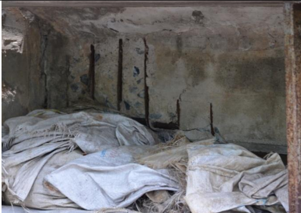
คอนกรีตหุ้มหลุดล่อน และเหล็กเสริมสูญเสียหน้าตัด
