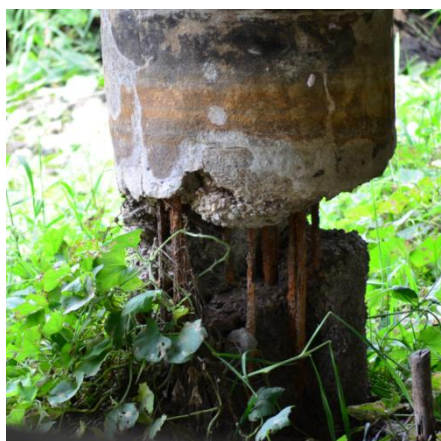
คอนกรีตหายไป เหลือแค่เหล็กเสริม
