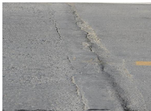
คอสะพานมีความต่างระดับมาก
