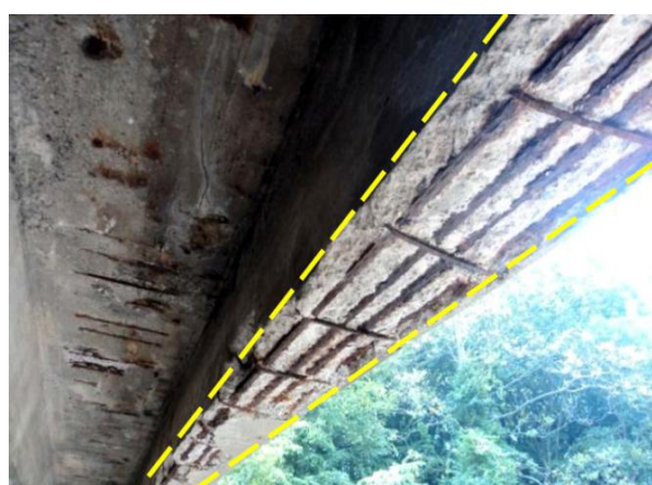
คอนกรีตหุ้มหลุดล่อน และเหล็กเสริมสูญเสียหน้าตัด
