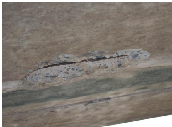
คอนกรีตหุ้มหลุดล่อนและเหล็กเสริมขึ้นสนิม
