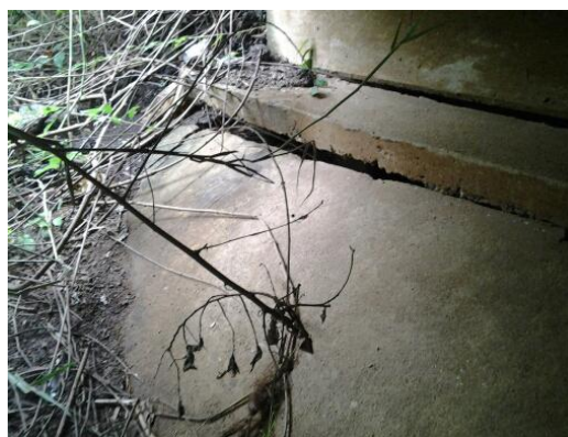
มีรอยแยกของโครงสร้าง
