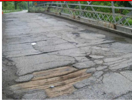
ผิวทางหลุดล่อน จนเห็นโครงสร้างพื้นสะพาน
