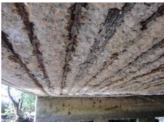
คอนกรีตหุ้มหลุดล่อน เหล็กเสริมเกิดสนิม
