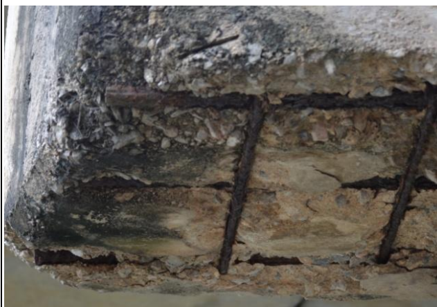
ไม่มีคอนกรีตหุ้มเนื่องจากการก่อสร้างไม่ได้มาตรฐาน ทำให้เหล็กเสริมเกิดสนิม และสูญเสียหน้าตัด
