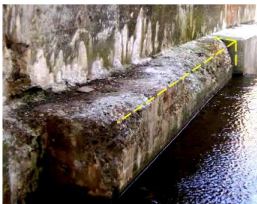
คอนกรีตหุ้มโครงสร้างป้องกันตอม่อหลุดล่อน
