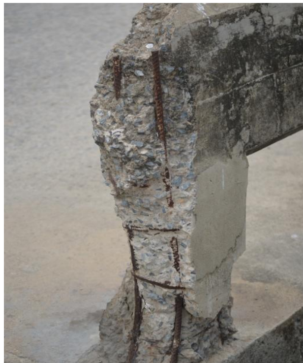
ราวสะพานวิบัติ เหล็กเสริมโผล่
