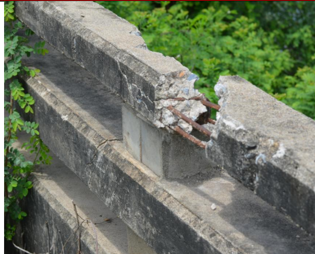
ราวสะพานวิบัติ คอนกรีตหายไปเหลือแค่เหล็กเสริม
