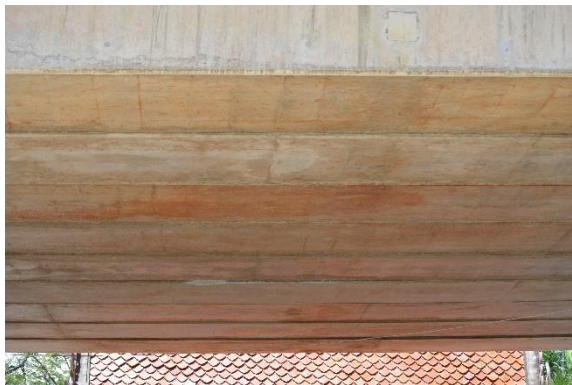
พื้นสะพานมีรอยแตกเล็กน้อย
