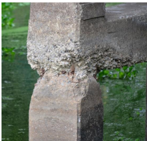
คอนกรีตหุ้มหลุดล่อนจนถึงเหล็กเสริม
