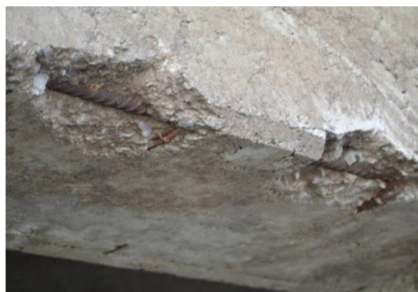
คอนกรีตหุ้มหลุดล่อนและเหล็กเสริมเป็นสนิม
