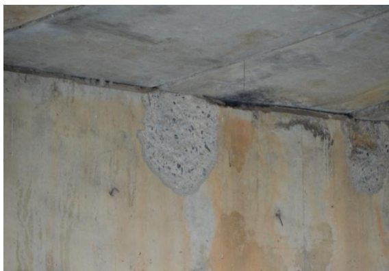
คอนกรีตหุ้มกระแทงออก แต่ยังไม่ถึงเหล็กเสริม
