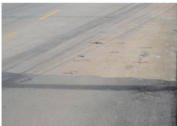
มีความต่างระดับของคอสะพานกับสะพานเล็กน้อย
