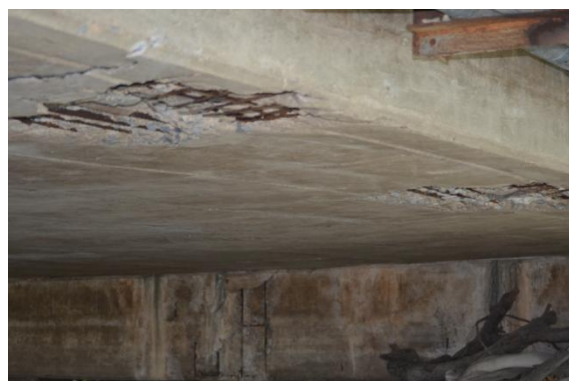
คอนกรีตหุ้มหลุดล่อนและเหล็กเสริมขึ้นสนิม
