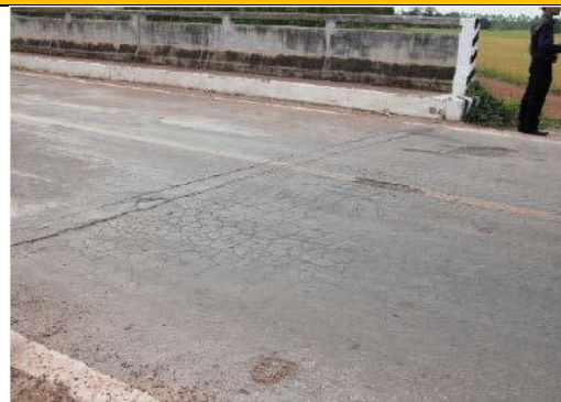
มีรอยแตกเป็นหนังจะเข้าบริเวณคอสะพาน
