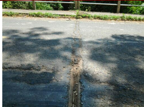
รอยต่อแตกออก มีขนาดใหญ่กว่า 10 ซม.
