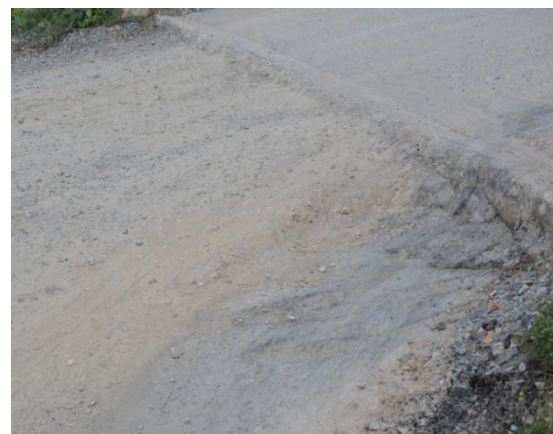
คอสะพานมีความต่างระดับมาก รถต้องชะลอ
