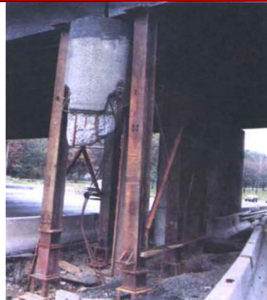
เสาตอม่อขาด ไม่สามารถรับน้ำหนักได้
