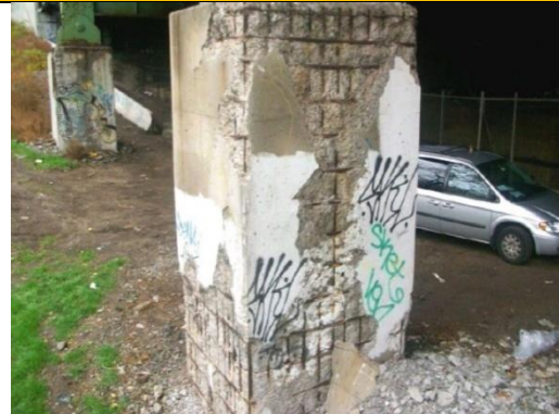
คอนกรีตหุ้มหลุดล่อนออก เหล็กเสริมเกิดสนิม
