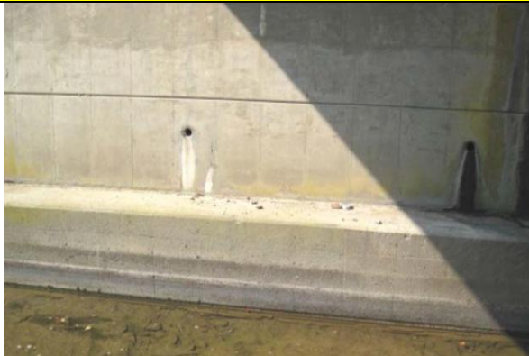
โครงสร้างป้องกันตอม่อมีรอยแตกเล็กน้อย
