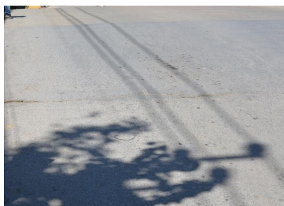
มีความต่างระดับของคอสะพานกับสะพานเล็กน้อย
