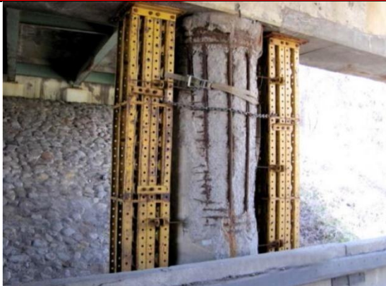
เสาตอม่อสูญเสียกำลัง ไม่สามารถรับน้ำหนักได้
