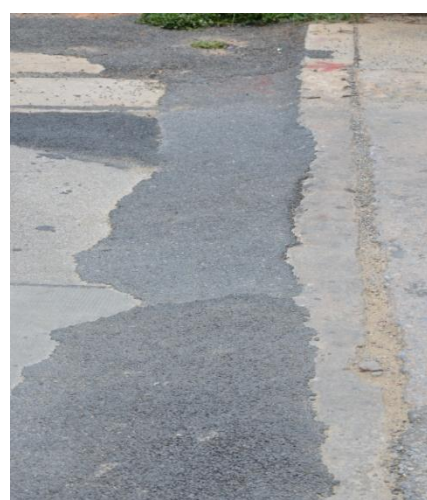
คอสะพานมีความต่างระดับมาก
