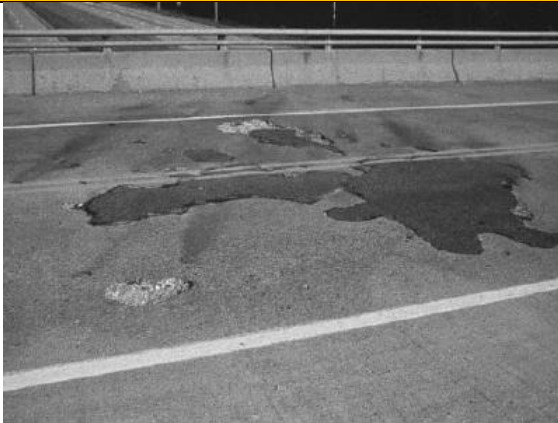
ผิวทางเป็นหลุม และมีรอบปะทุขึ้น
