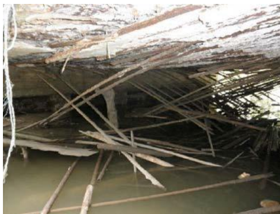
คอนกรีตหุ้มหลุดล่อน เหล็กเสริมเกิดสนิม
