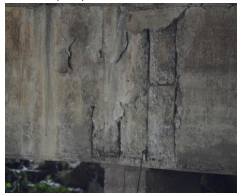
คอนกรีตหุ้มหลุดล่อนและเหล็กเสริมเป็นสนิม
