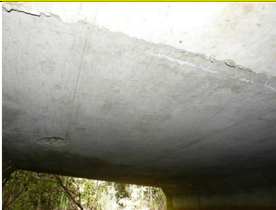
พื้นสะพานมีคอนกรีตหลุดล่อนเล็กน้อย
