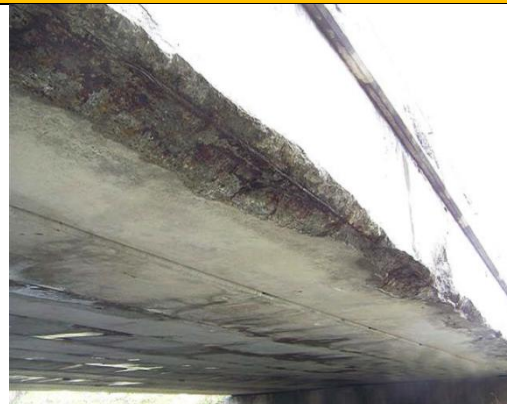
คอนกรีตหุ้มหลุดล่อนและเหล็กเสริมเป็นสนิม
