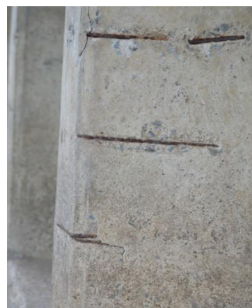
คอนกรีตหุ้มหลุดล่อนออก เหล็กเสริมเกิดสนิม
