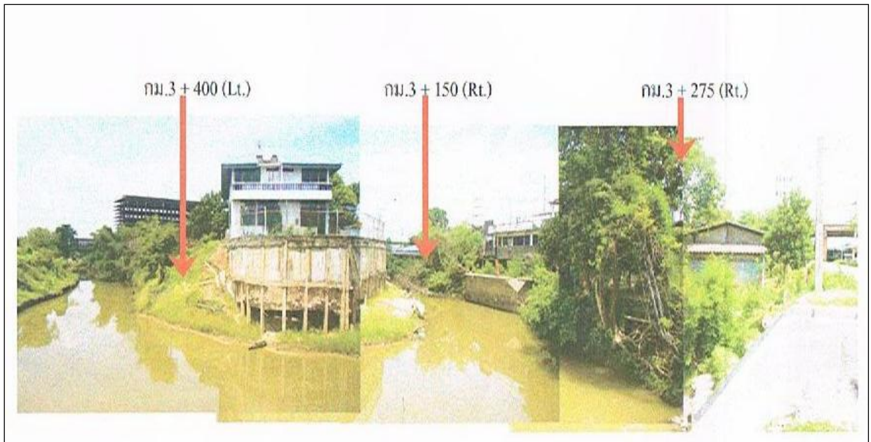
รูปที่ 15 ความเสียหายจากการเกิดอุทกภัย ปี 2551 (ก่อนก่อสร้าง)
