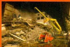
อาคารถล่มจากการเกิดอัคคีภัย
