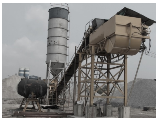
รูปที่ 7 โรงผสมแบบผสมต่อเนื่อง (Continuous Mixing Plant)
