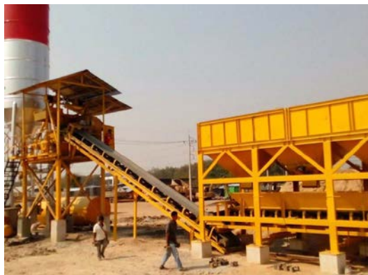
รูปที่ 1 โรงผสมแบบชุด (Batch Mixing Plant)
