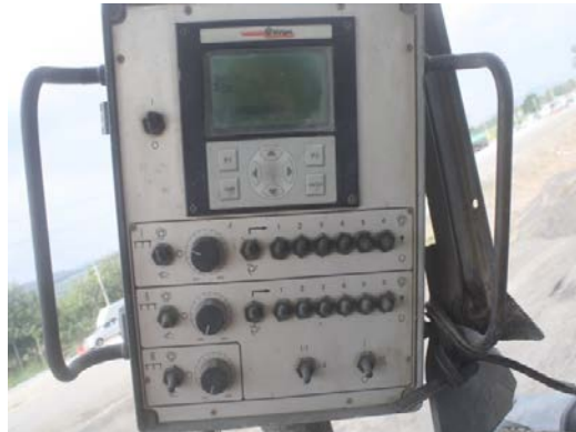
รูปที่ 66 แสดงแผงควบคุมการตั้งค่าปริมาณน้ำ
