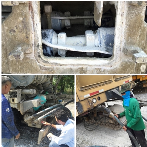
รูปที่ 39 เครื่องส่ง และสายส่งน้ำปูนซีเมนต์ ไปยังเครื่องจักรชุดตัดผสม
