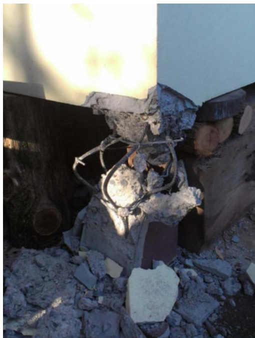
รูปที่ 7.2 การวิบัติของเสาตอม่อ (เสาสั้น)
