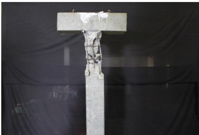
รูปที่ 7.6 (ก) ตัวอย่างเสาที่ได้รับ ความเสียหายที่หัวเสา
