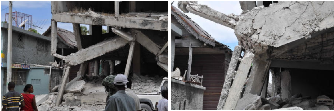
รูปที่ 2.1 อาคารที่วิบัติเนื่องจากแผ่นดินไหว สำหรับ 2010 Haiti Earthquake ขนาด 7.0 เนื่องจากเสวมี่ขนาดเล็กมากเมื่อเปรียบเทียบกับพื้นที่เชื่อมต่อเข้าด้วยกัน รวมถึงมีการเสริมเหล็กในเสวและจุดต่อไม่เหมาะสม
