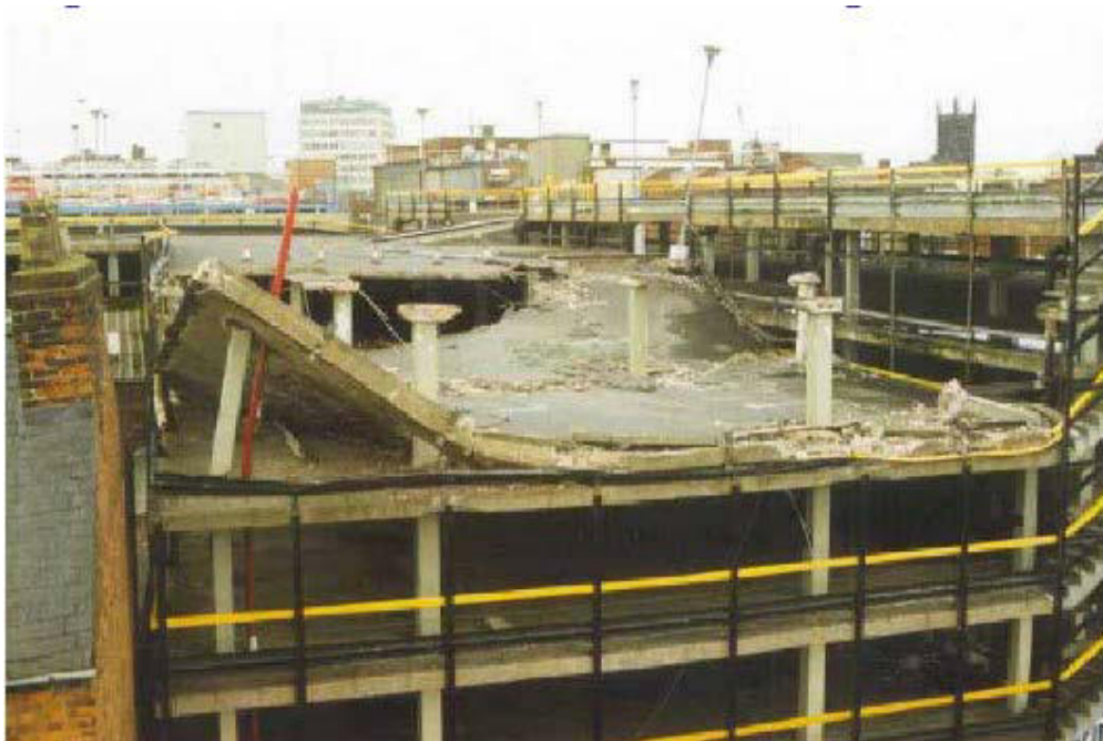
รูปที่ 6.25 การวิบัติเฉือนทะลุในพื้นไร้คาน (ที่มา: http://failuremechanisms.wordpress.com )
