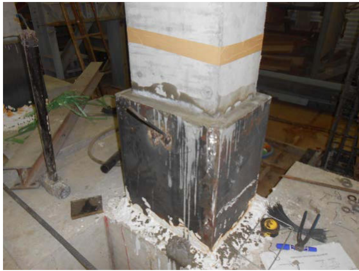
รูปที่ 6.1 (ข) ลักษณะของเสาที่เสริมกำลังด้วยการหุ้มด้วย แผ่นเหล็กแล้ว
