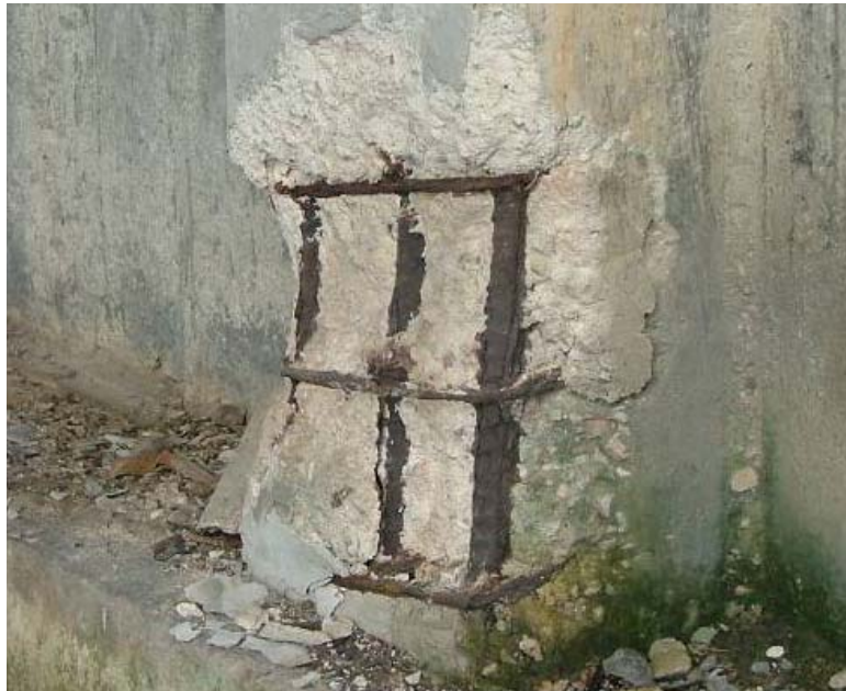
รูปที่ 2: รูปการกระแทกออกของผิวคอนกรีต
