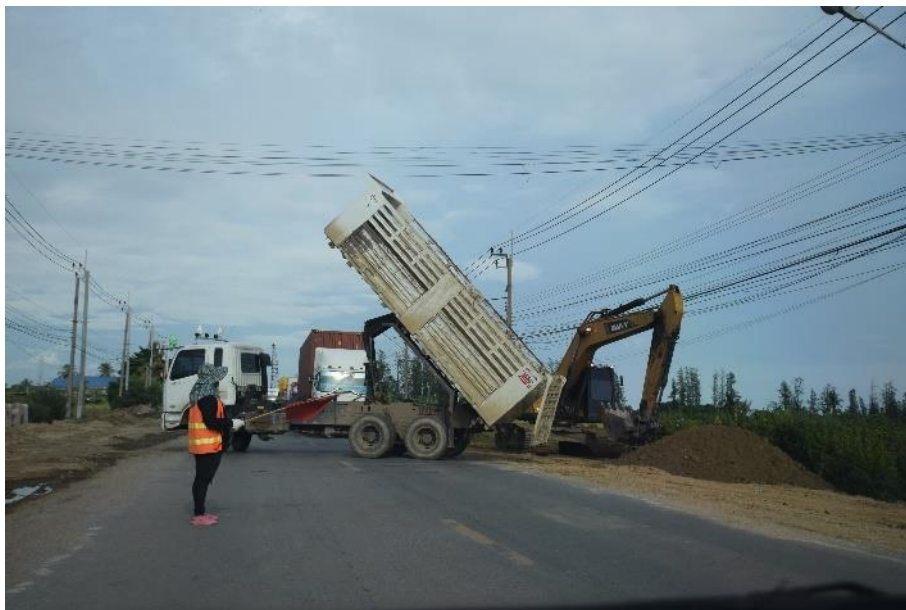
รูปที่ 1.1-8 การทำงานของรถบรรทุกเททรายกีดขวางการจราจรที่อาจเป็นอันตรายต่อผู้สัญจร
