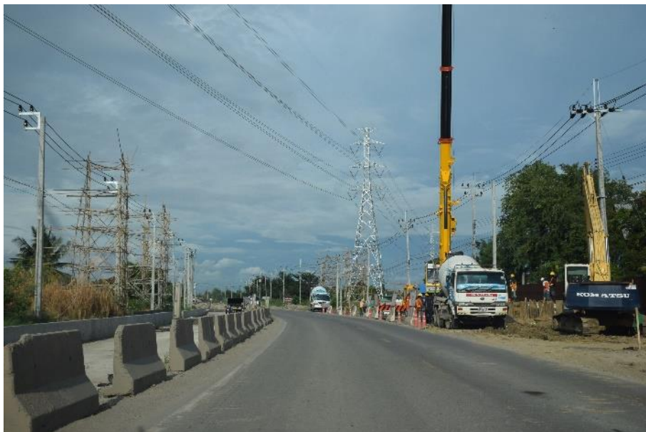
รูปที่ 1.1-9 การติดตั้งอุปกรณ์ควบคุมก่อสร้างที่อาจเป็นอันตรายต่อผู้สัญจร
