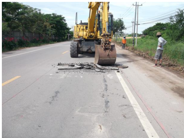
รูปที่ 4.1 ภาพการแก้ไขถนน ส่วนที่เกิดความเสียหายก่อนทำการฉาบผิวสเลอรี่ซีล
