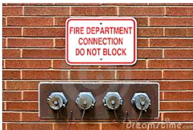
รูปที่ 19.11 แสดงหัวรับน้ำดับเพลิง หรือ Fire Department Connection
