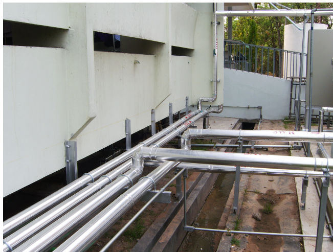
รูปที่ 2.15 ระบบท่อน้ำร้อนภายนอกอาคารที่หุ้มฉนวนพร้อมฝาครอบโลหะ
