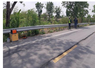
รูปที่ 11 สภาพความเสียหายจากการทรุดตัวบนสายทาง ปท.3034 (ที่มา: คณะทำงานฯ)
