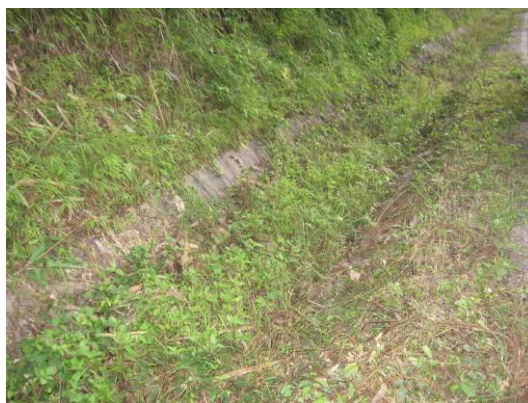
(ณ) วัชพืชขึ้นบนดินที่มาทับถมใน รางระบายน้ำ
