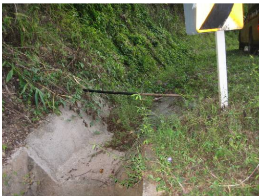
(จ) วัชพืชขึ้นบนเศษก้อนดิน/หิน ในวางระบายน้ำ
