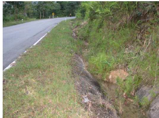
(ง) วัชพืชขึ้นบนเศษก้อนดิน/หิน ในวางระบายน้ำ
