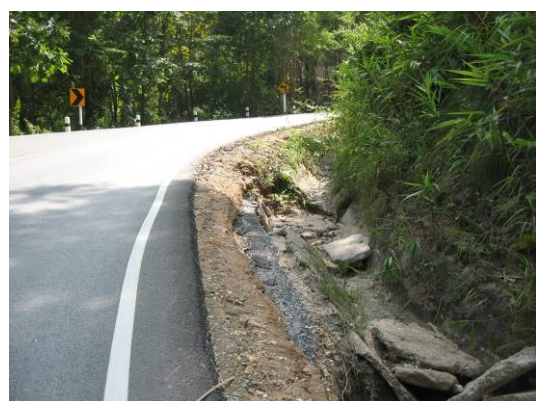
(ฉ) ก้อนหินร่วงหล่นมาทับถม ในวางระบายน้ำ
