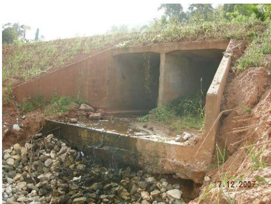
(ก) การกัดเซาะด้าน Outlet ของปลายปากท่อเหลี่ยม
