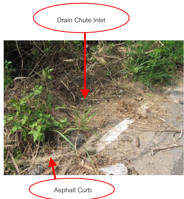
(ข) Drain Chute Inlet ที่ขาดการบำรุงรักษา ระบบระบายน้ำใช้การไม่ได้
