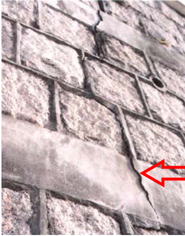
(ก) รอยแตกของ Retaining Wall
