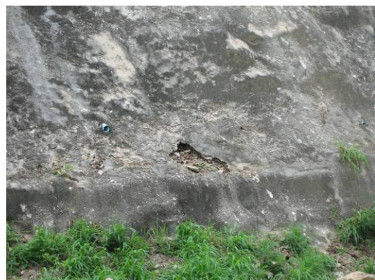
(ข) การแตกของ Shotcrete
