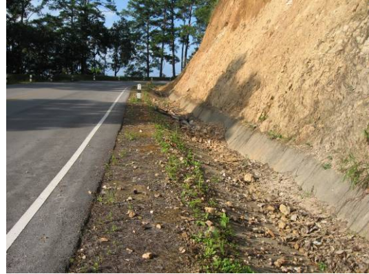
(ข) วางระบายน้ำถูกทับถมด้วย เศษก้อนดิน/หินจาก Back Slope
