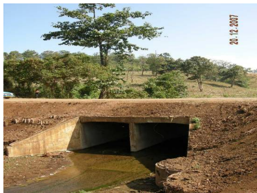
(ข) ตะกอนดินขังหน้า Inlet ของปากท่อเหลี่ยม
