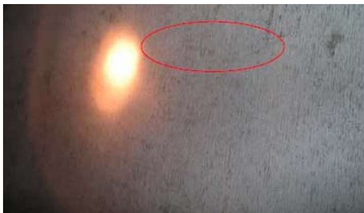
รูปที่ 26 Hairline Crack
