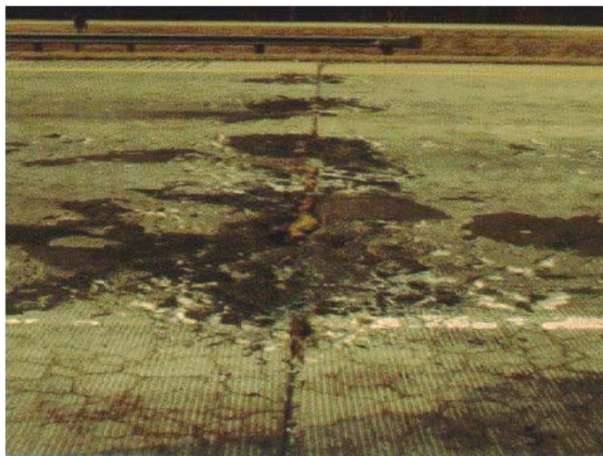
รูปที่ 52 Pattern Cracking (Alkali – Carbonate Reaction)
