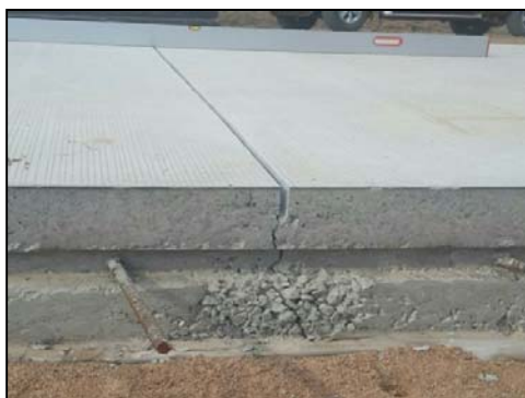
รูปที่ 146 การอัดแต่งไม่ดีจึงทำให้เกิดการแยกตัวของคอนกรีต
