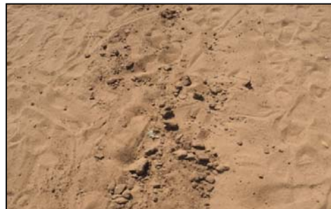
วัสดุทรายรองถนนคอนกรีตที่ไม่ดี
