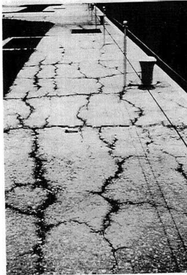
รูปที่ 51 Pattern Cracking (Alkali - Silica Reaction)
