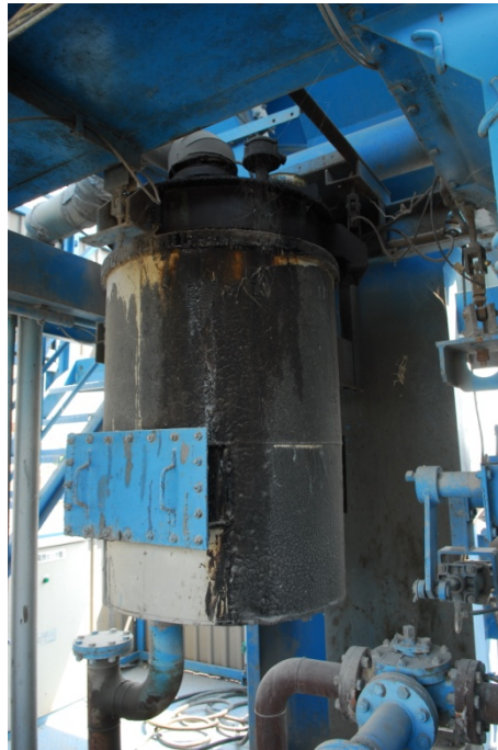
รูปที่ 2.9 ชุดอุปกรณ์ควบคุมปริมาณแอสฟัลต์ซีเมนต์
