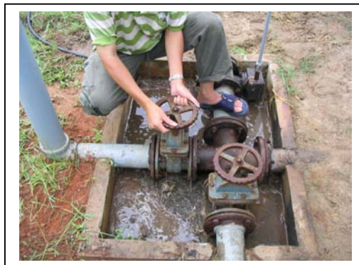
รูปที่ 58 เปิดประตุน้ำลงถังน้ำใส (ประตุน้ำหมายเลข 3)
