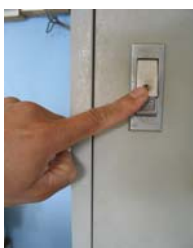
รูปที่ 10 ปุ่มล็อกฝาตู้ควบคุมเครื่องสูบน้ำดิบ
