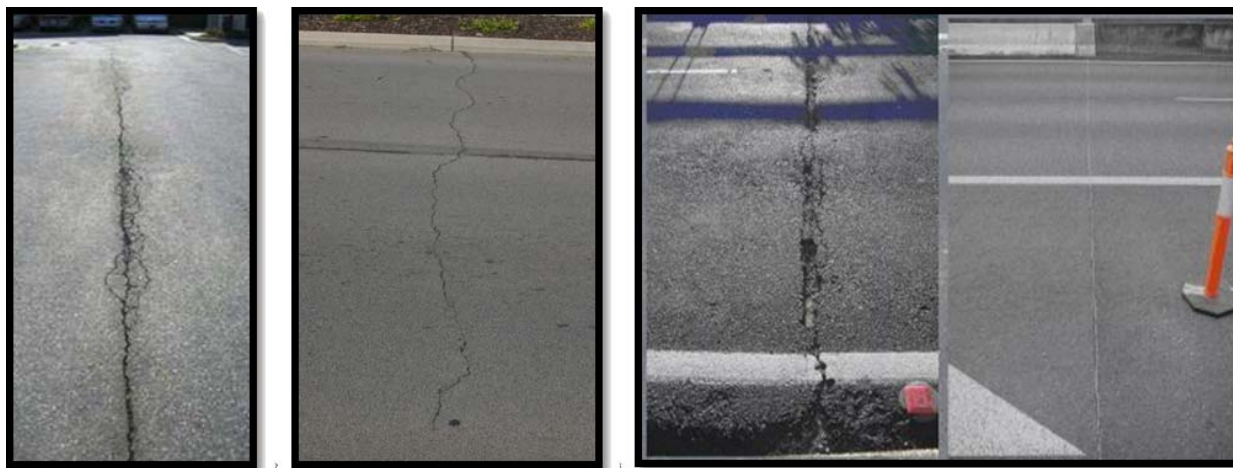
รูปที่ แสดงรอยแตกร้าวของผิวทางบริเวณรอยต่อสะพาน
