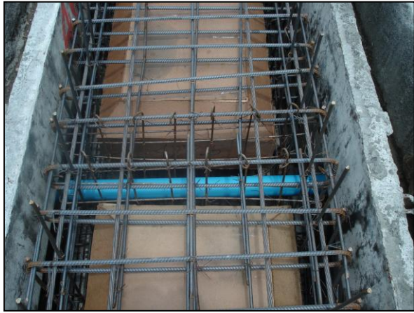
รูปที่ ๖-๒๔ ท่อสำหรับทำเป็นรูร้อยเหล็กกรัดคาน (Tie Rod)
