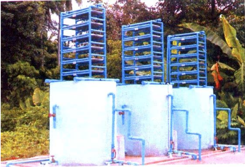
รูปที่ 7 ถังกรองตะกอนและสนิมเหล็กในระบบกรองน้ำ
