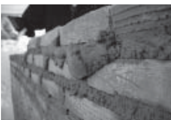
ข) ลักษณะเนื้อปูนก่อที่มีความเหนียวยึดเกาะก่อนอิฐดี ไม่ร่วงหล่นในขณะเคาะอิฐให้ไต่ระดับ
