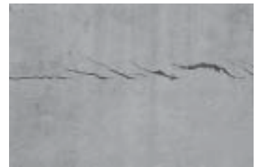
รูปที่ 6-18 ผนังแตกร้าวบริเวณใต้ท้องคาน เนื่องจากการก่ออิฐไม่ถูกวิธี
