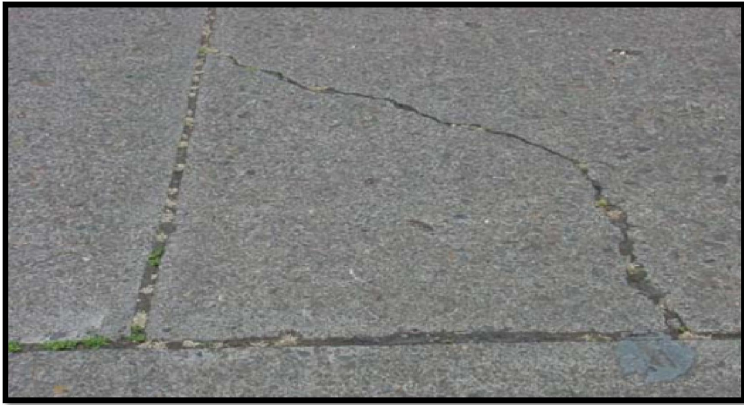
รูปที่ 37 ความเสียหายผิวทางคอนกรีตประเภทรอยแตกตามมุม
