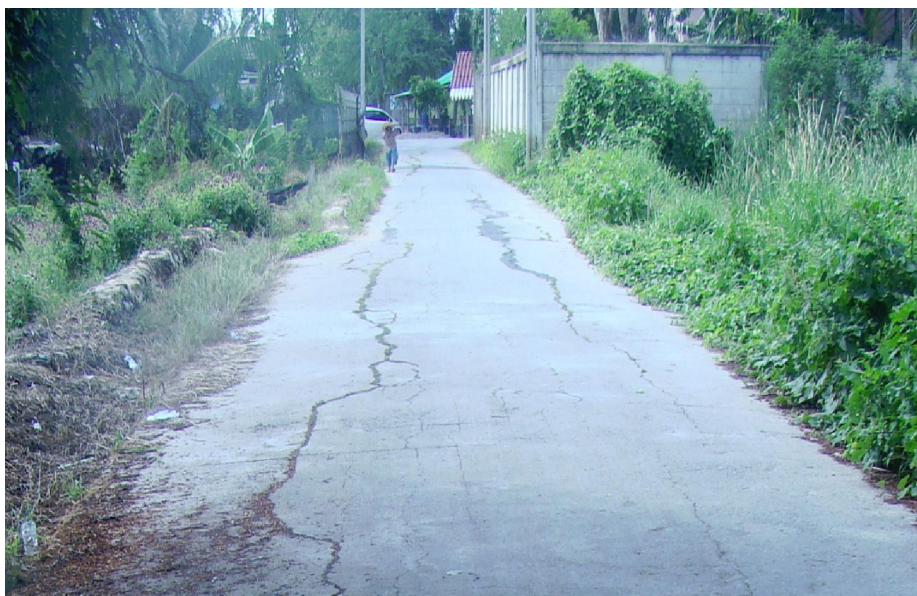
รูปที่ 43 ความเสียหายผิวทางคอนกรีตประเภทแผ่นคอนกรีตเสียหายทั้งแผ่น
