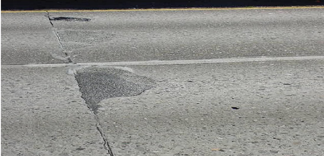
รูปที่ 39 ความเสียหายผิวทางคอนกรีตประเภทรอยปะซ่อมที่เสียหาย
