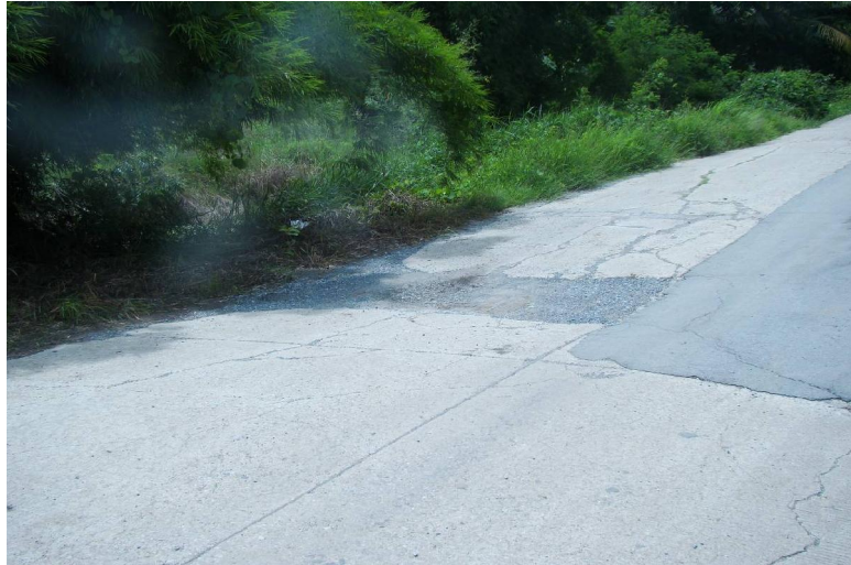
รูปที่ 41 ความเสียหายผิวทางคอนกรีตประเภทแผ่นคอนกรีตทรุดตัว
