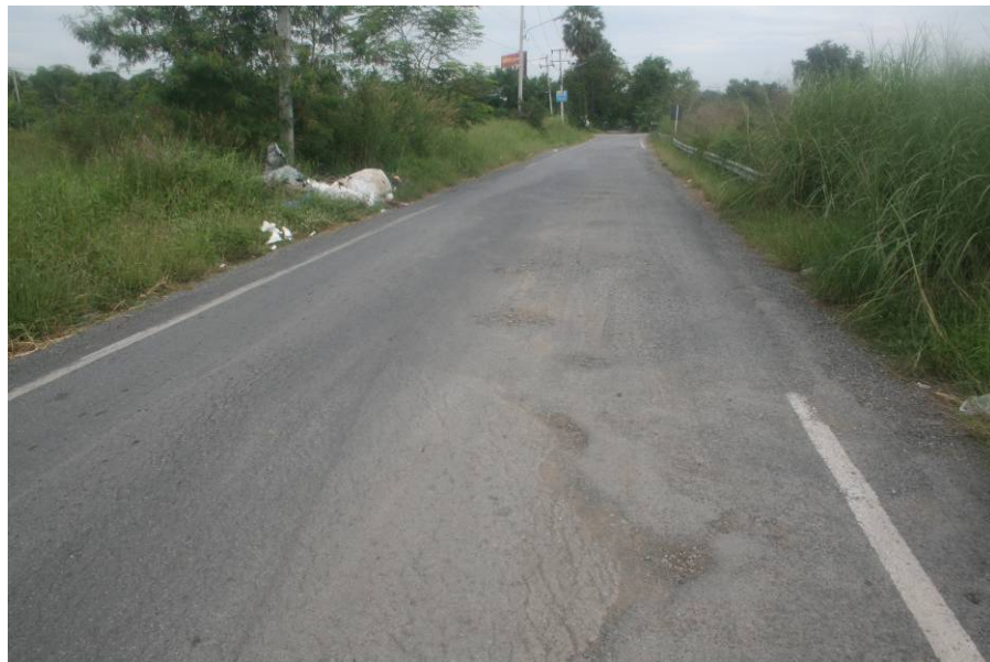
รูปที่ 2.6 ลักษณะการยุบตัวและปูดตัวของพื้นถนน
