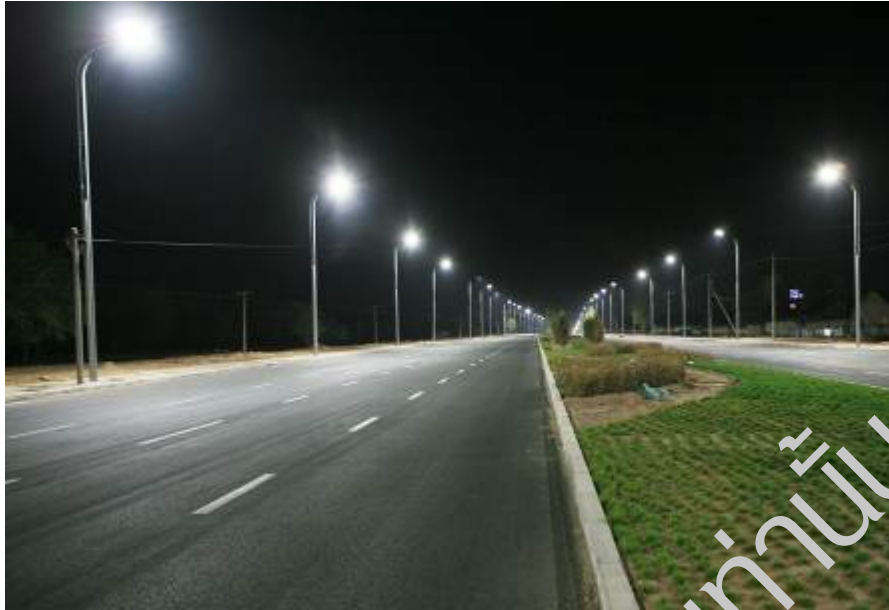
รูปที่ ข-3 ไฟฟ้าแสงสว่างทางหลวง แบบประหยัดพลังงาน โอลิมปิก
