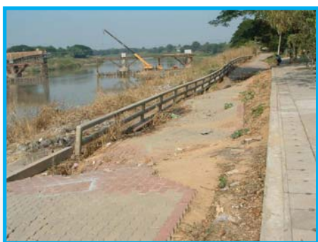
ความเสียหายของเขื่อนป้องกันตลิ่ง จ.สิงห์บุรี
