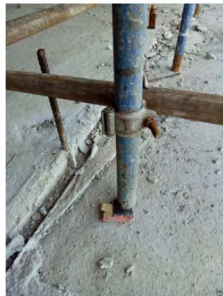
(ค) ใช้แผ่นไม้รองไม่เต็มหน้าเสา
