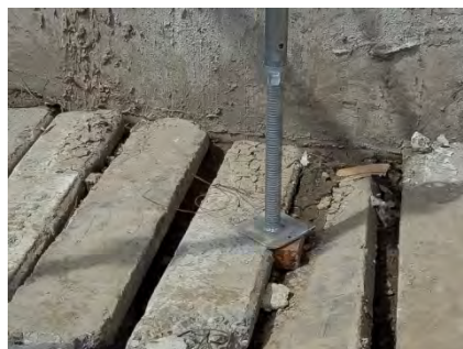
(จ) วางแผ่นรองเสาไม่พอดีกับพื้นรองรับ
